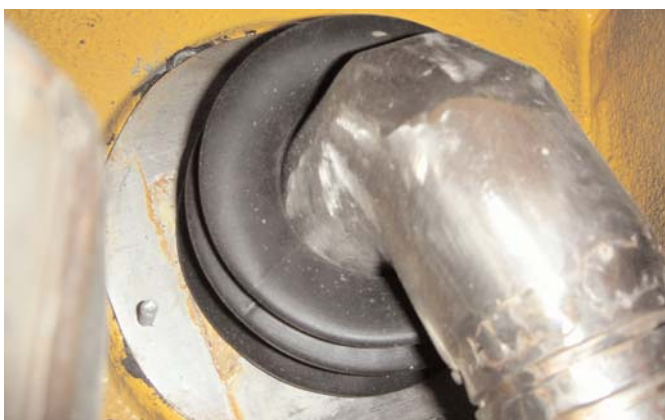
Übergang des V2A-Rohr zum Sportluftfilter
