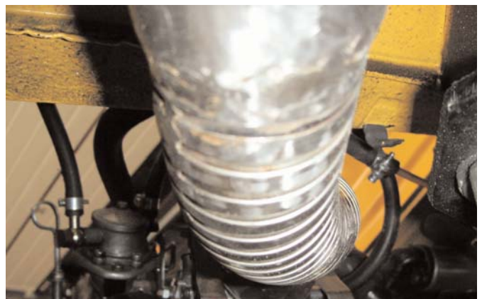
Flexibles V2A-Rohr als Ansaugschlauch
